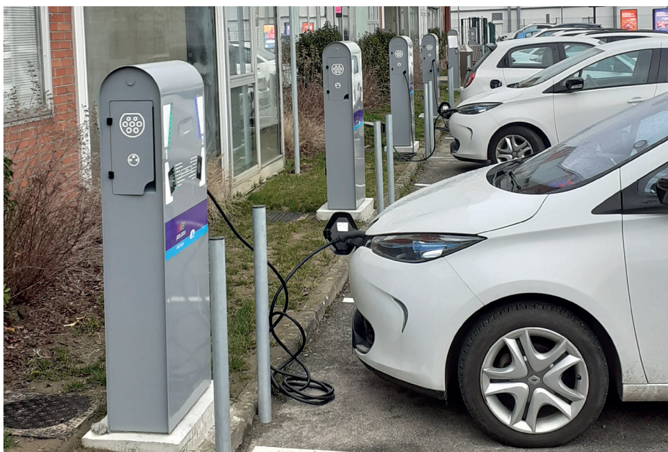
Bornes de recharge pour véhicules électriques
